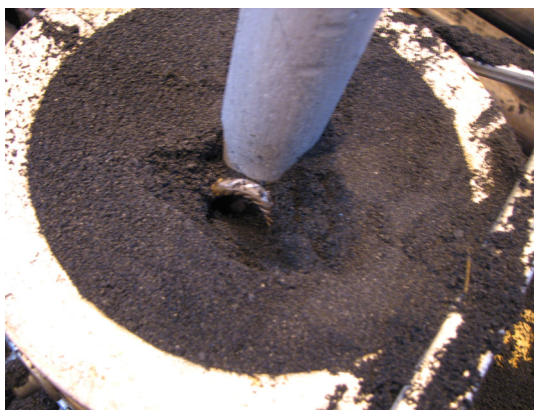
Kuva 75. Nostolenkki kaasunpoistokanavan vieressä
