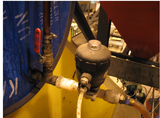
Kuva 226. Hartsisideainekierron putken paluuputken hana auki
