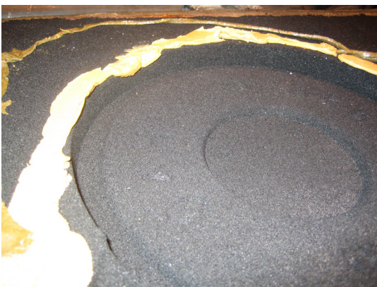
Kuva 340. Virheellisesti asetettu liima (huomaa paksu liimakerros) ja tiivistenauha
